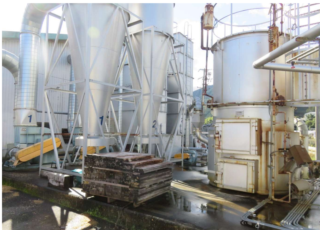
ボイラー・集塵設備
