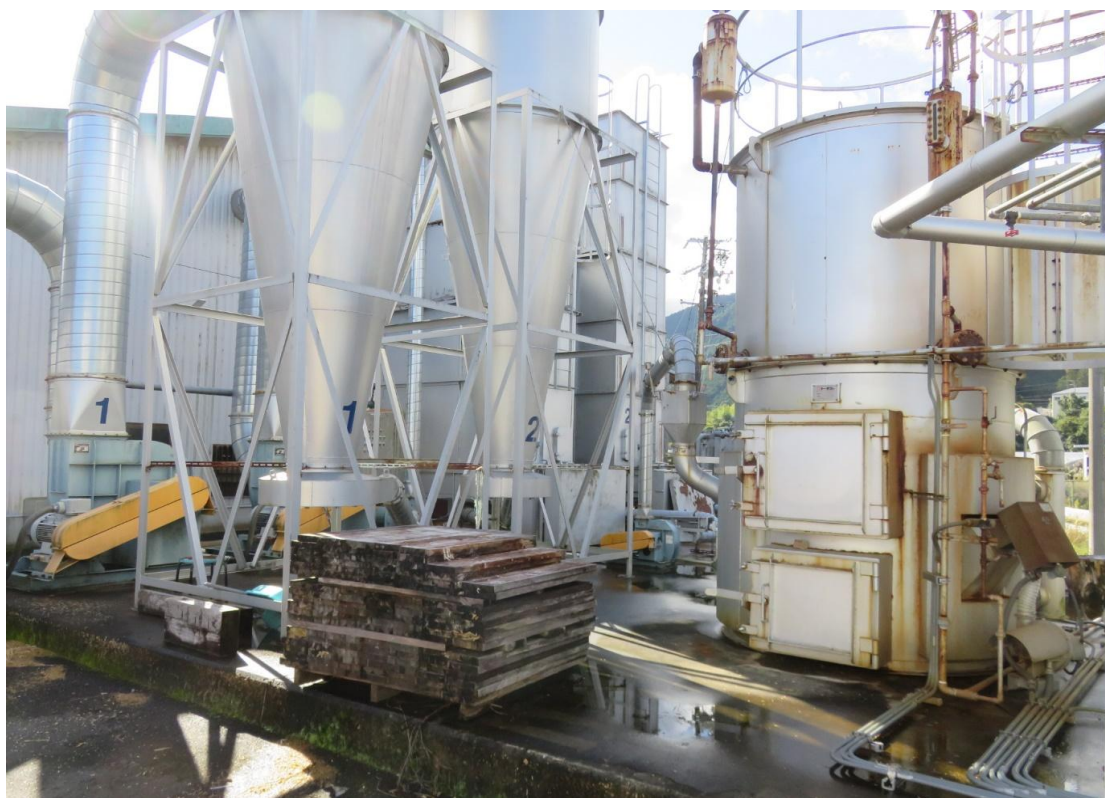
ボイラー・集塵設備
